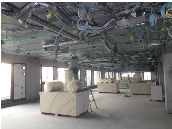
【写真①B棟14階天井裏配管・配線の様子】
